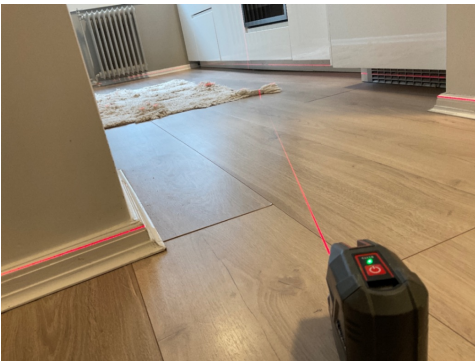
Nivellering entré + kjøkken, avvik ca. 10-20 mm
