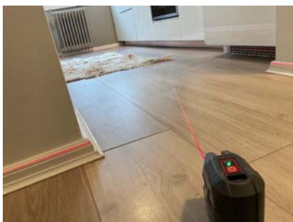
Nivellering entré + kjøkken, avvik ca. 10-20 mm
