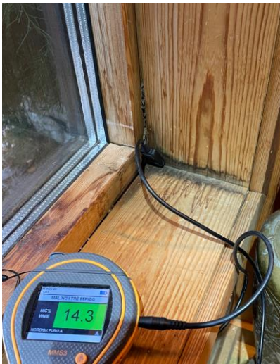
Eldre fuktskader vinduskarm
