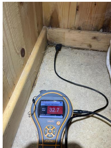
Fuktmåling bod under terreng list
