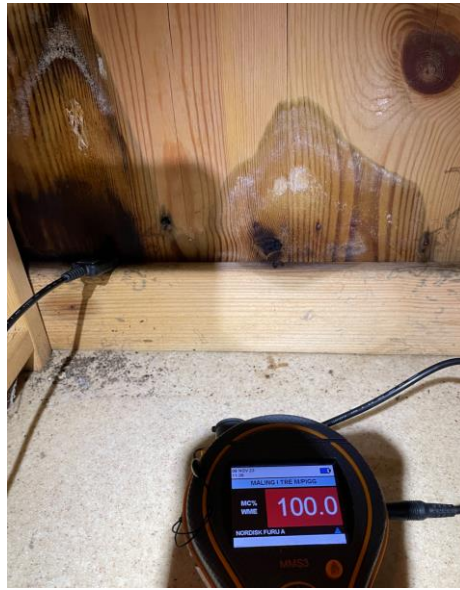
Fuktmåling råteskade bod.
