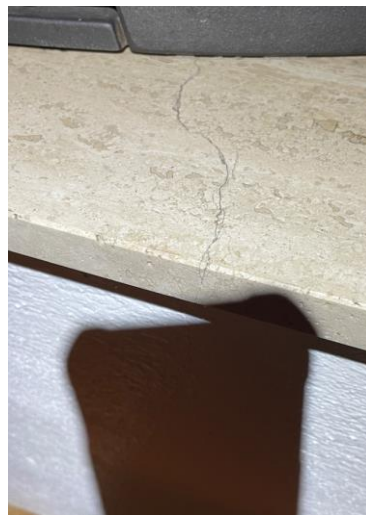
Sprekk i pipepuss og dekorstein
