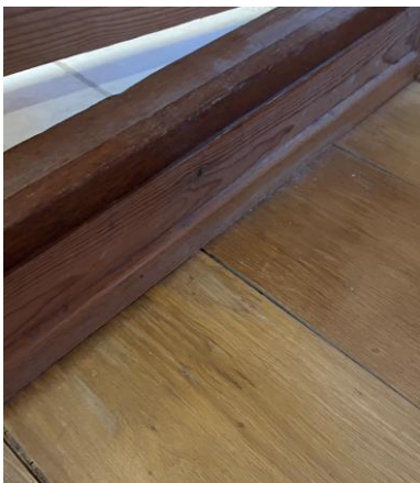
Fuktbelastet parkett ved bad
