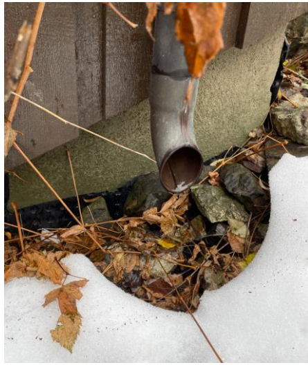
fuktbelastning med defekt gr.list
