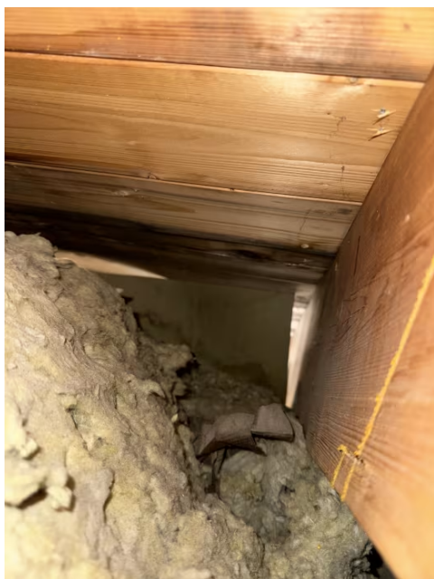
Det registreres noe misfarging mot undertak i raftekott.
