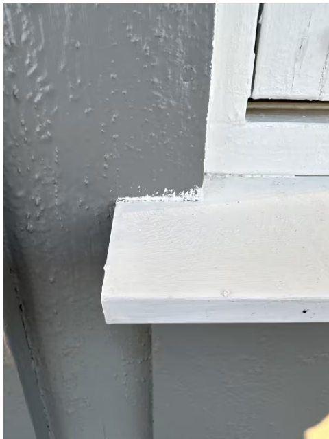
Kledningen montert helt ned til vannbrettet. Fare for fuktopptrekk.
