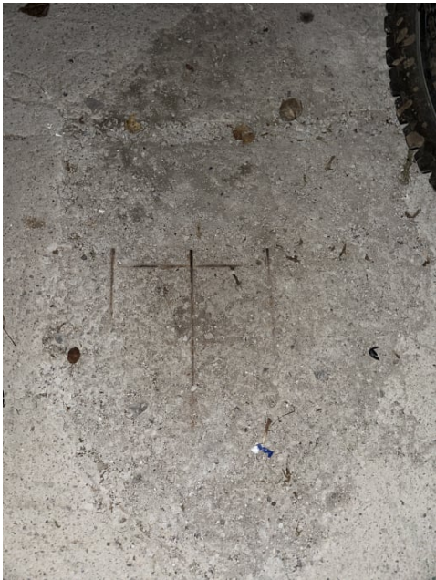
Det registreres skader i betong. Antatt rustspreng i armering.
