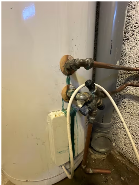
Viser drypplekkasje og irr på koblinger.
