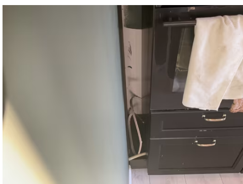
Viser manglende foring i overgang kjøkken og vegg.
