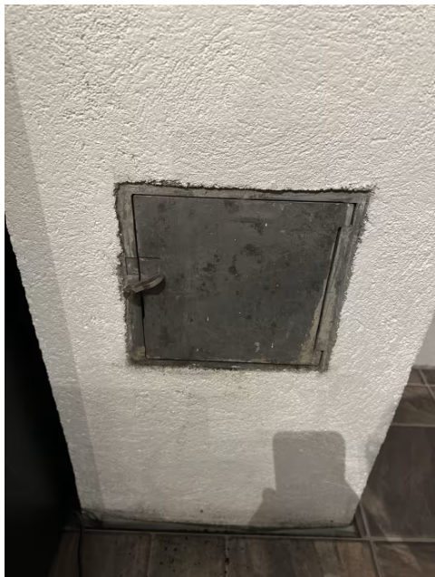
Sotluke plassert i kjellerstue.
