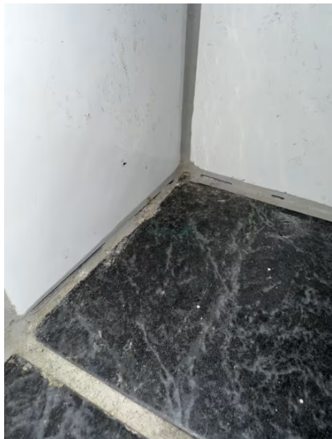
Viser sprekke i fugemasse i overgang gulv/ vegg.
