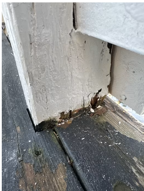
Det er påvist stedvis råteskader ved rekkverk.
