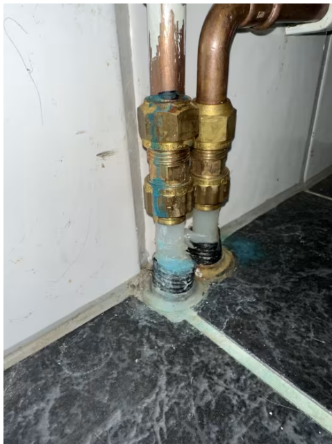
Rørføringer gjennom gulv har ikke synlig membran / mansjetter over gulvet.
