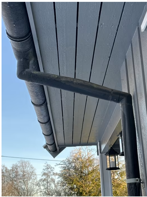
Nedløpsrør med frostspreg.
