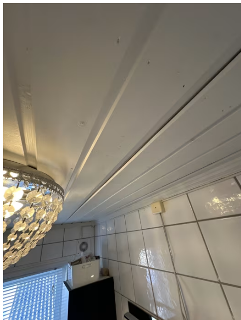
Viser panelbord i himling med lokal utglidning.
