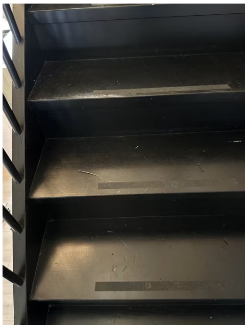
Det registreres enkelte sår og hakk i trappetrinn.
