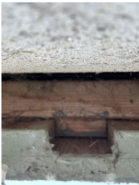
Det er benyttet klosser som musesperre bak kledning. Dette medfører redusert lufting.
