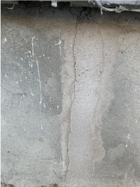
Viser sprekke i grunnmur.
