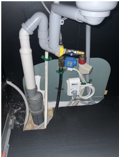
Viser vann- og avløpsinnstallasjoner under kum.
