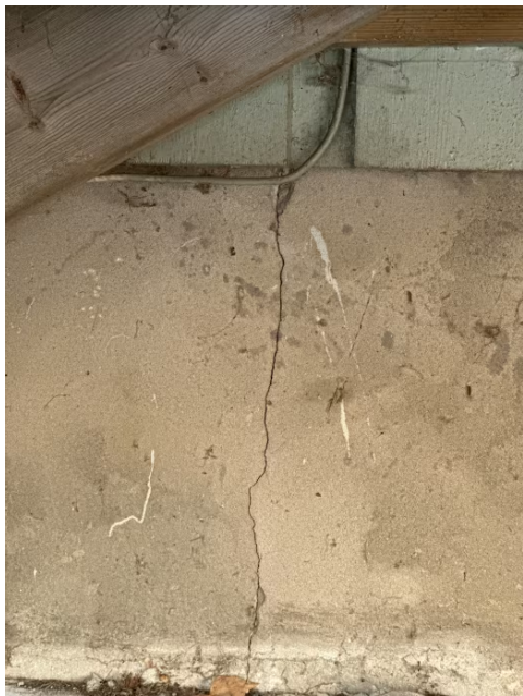
Viser sprekk i grunnmur.
