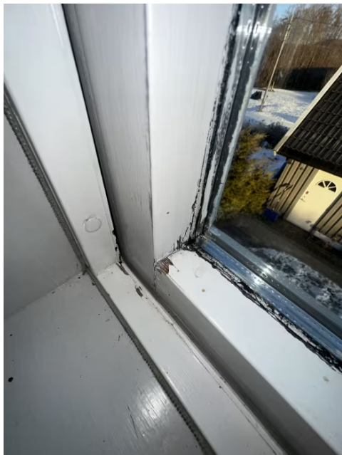
Misfarging på innvendige karmen og foringer trolig pga. kondens. Anbefaler ytterligere undersøkelser.
