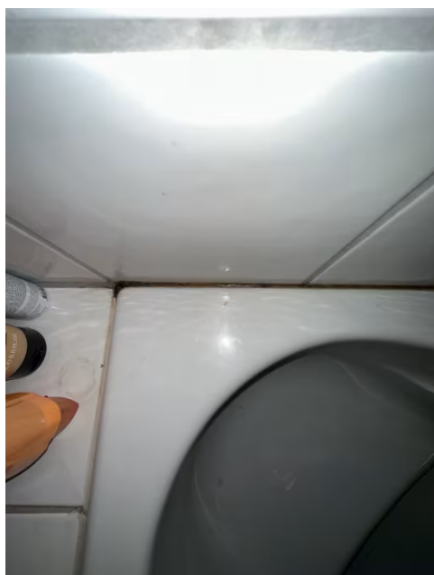
Misfarget fugemasse i overgang badekar/vegg bør utbedres. Utettheter ved hjørne mot flis.
