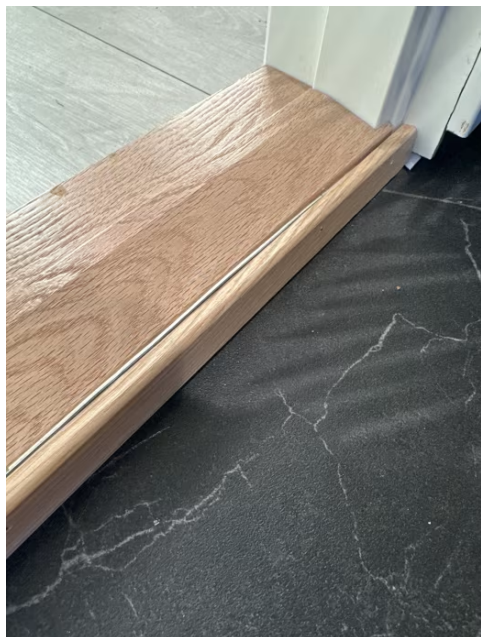
Synlig gulvbelegg klemt med list ved terskel.
