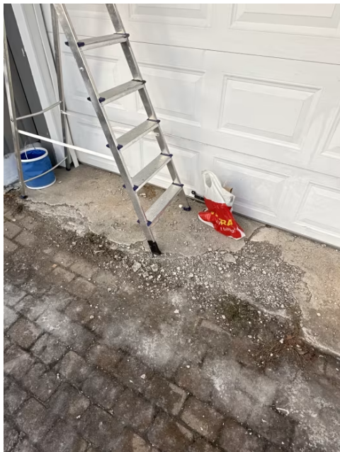
Viser skade/oppsmuldring ved støpt plate på mark.
