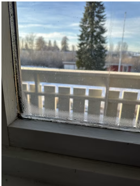
Det registreres kondens ved flere vinduer.
