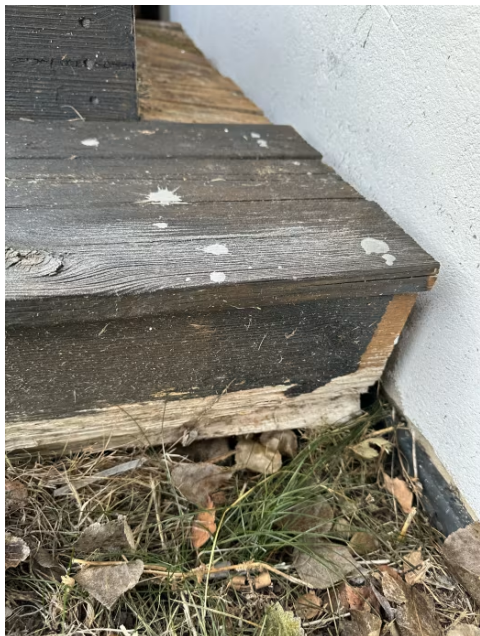
Viser råteskader i nedre del av terrengtrapp til terrasse.
