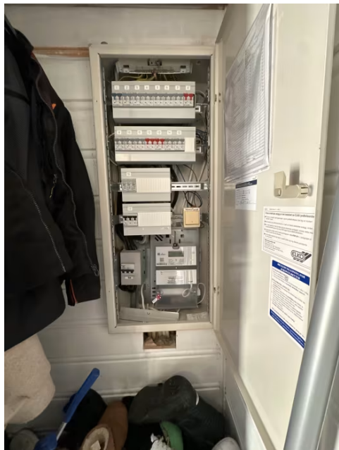
Viser sikringsskap plassert i skyvedørgarderobe.
