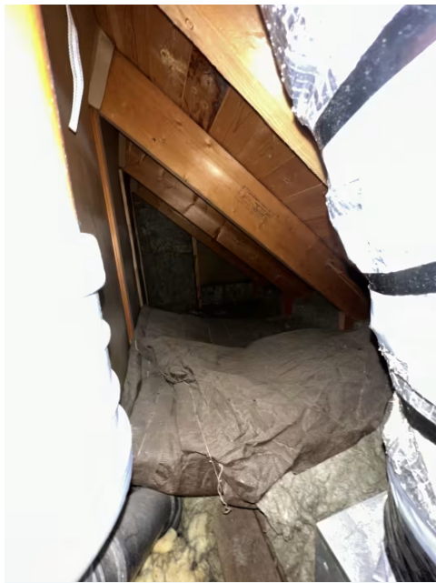
Viser raftekott mot syd, begrenset besiktigelse muligheter.
