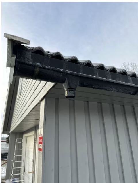
Takrenne mangler nedløpsrør på begge sider av takkonstruksjonen.
