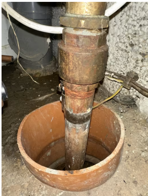
Viser irr og rust på vanninntak.
