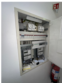
Sikringsskap med automatsikringer.
