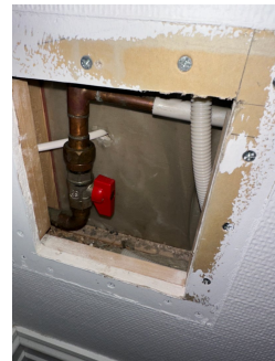
Stoppekran plassert bak luke i stue.
