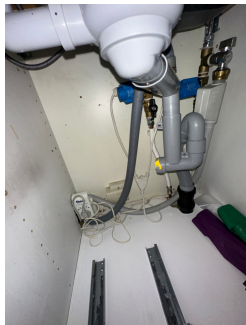
Rørøpplagg i kjøkkenbenk med Waterguard
