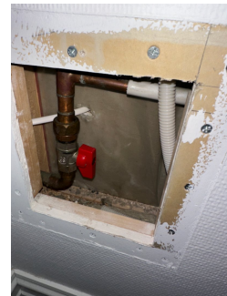
Stoppekran plassert bak luke i stue.
