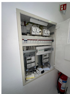
Sikringsskap med automatsikringer.
