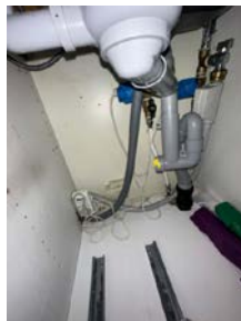
Røropplegg i kjøkkenbenk med Waterguard
