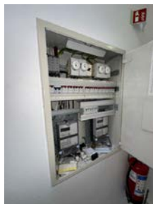
Sikringsskap med automatsikringer.
