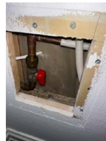
Stoppekran plassert bak luke i stue.
