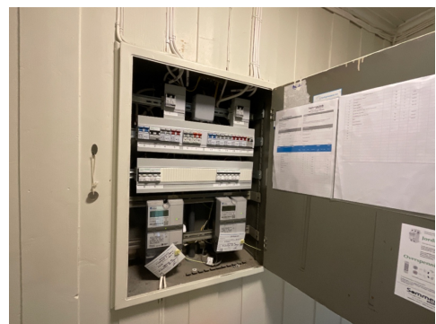
Sikringskap i felles trappega
