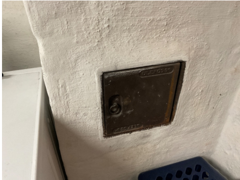
Sotluke i vaskekjeller
