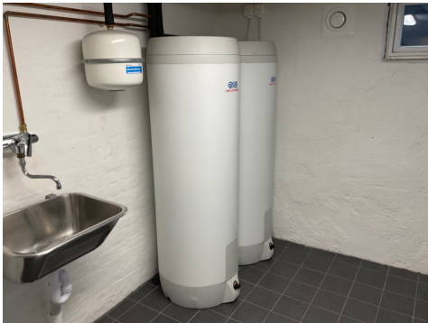
To varmtvannstanker til bygningen
