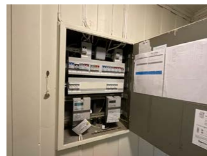
Sikringsskap i felles trappega
