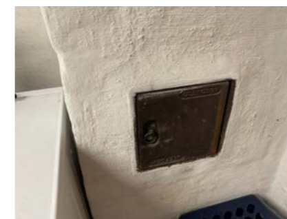
Sotluke i vaskekjeller
