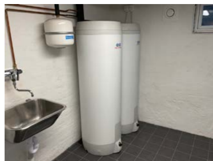
To varmtvannstanker til bygningen
