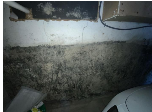
Mindre riss på grunnmur i garasjen.
