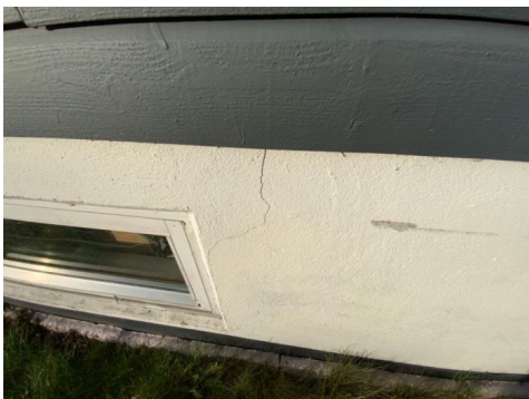
Stedvis synlig riss.
