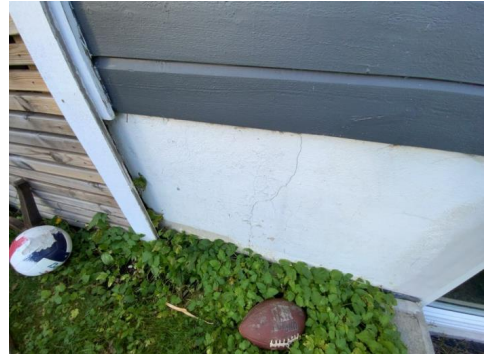
Stedvis synlig riss.
