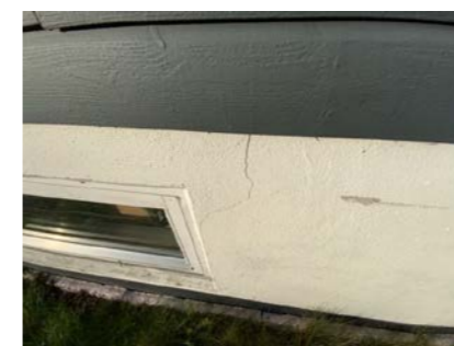
Stedvis synlig riss.
