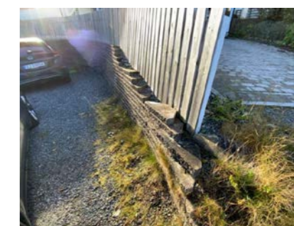
Konstruksjonene har skjevheter.
