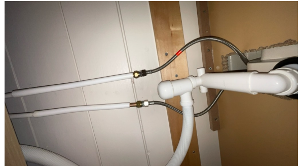
Del av rør til vann.
