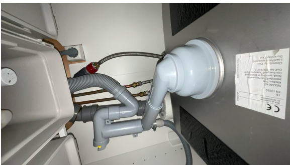
Del av rør til avløp.
