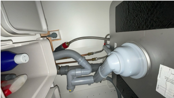
Del av rør til vann.
