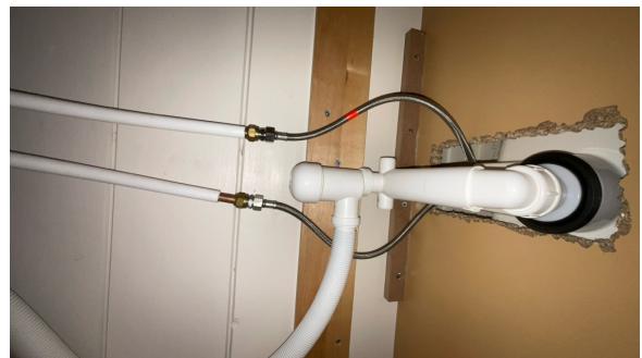
Del av rør til avløp.
