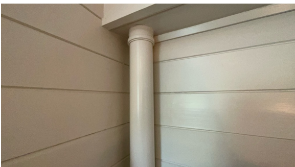
Del av rør til avløp.
