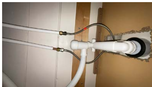
Del av rør til avløp.
