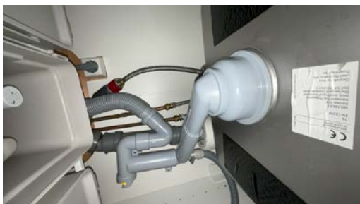
Del av rør til avløp.
