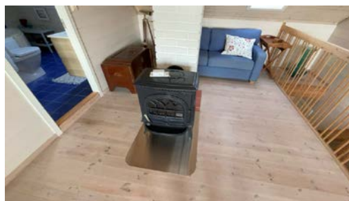
Montert ovn i stue 2 etasje.
