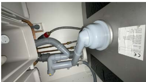
Del av rør til avløp.
