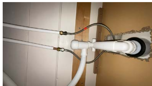
Del av rør til avløp.
