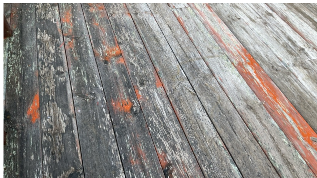
Terrassebord er slitt der det må påregnes vedlikehold/utskifting
