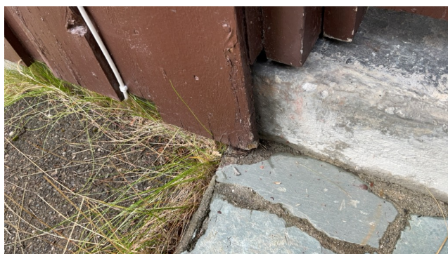
Vedlikeholdsbehov med bobler på maling
