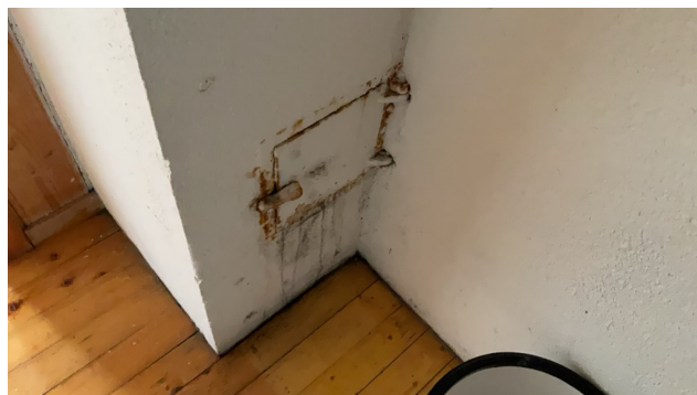
Manglende ubrennbar plate på gulv, rust og fuktmerker fra sotluke
