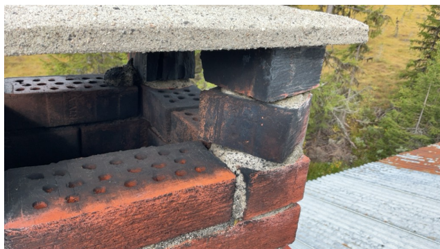
Løse hjørnesteiner og pipe over tak bør oppgraderes med hedekkende pipebeslag
