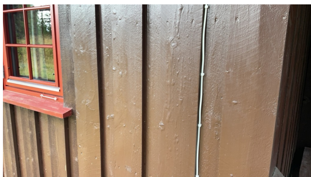
Bobling på maling stedvis
