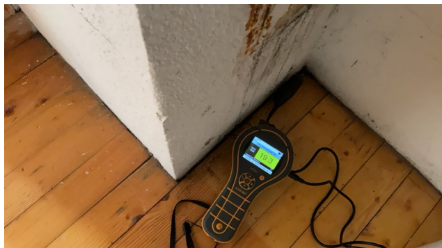
Ved fuktmåletaking av golv og ved fuktmåletaking av golv var det fuktutslag
