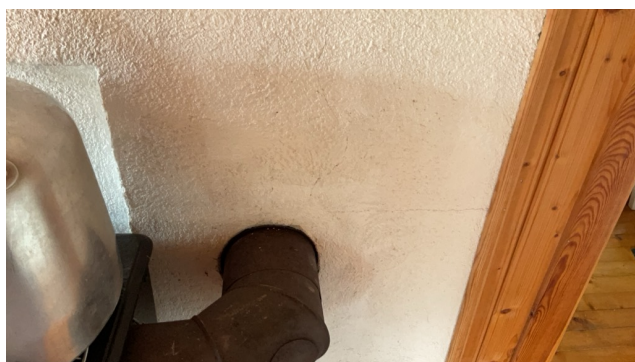
Riss/sprekke dannelse ved røykinnføring
