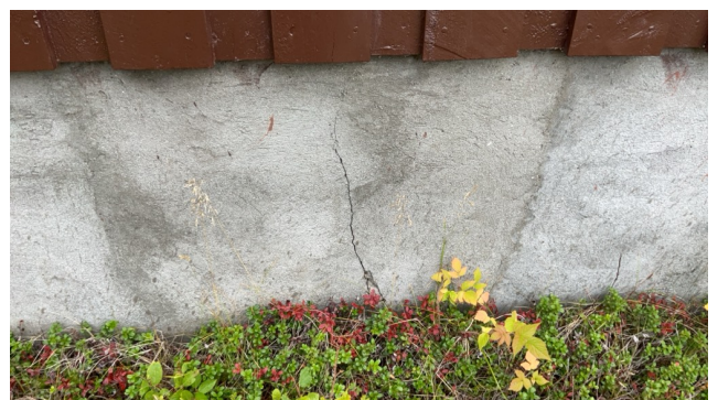
Sprekk i mur
