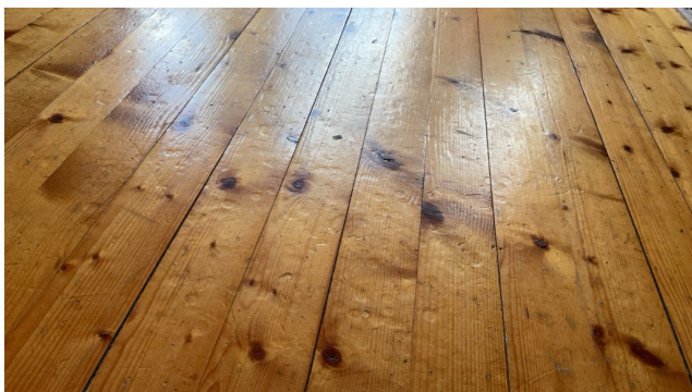
Merker og slitasje på gulvoverflate
