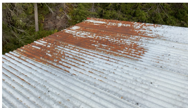
Rustskader på plater
