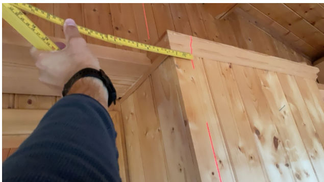
Ved stippørvestking er det på vegg målt skjevhet på oppmot 60 mm på 2 m høyde
