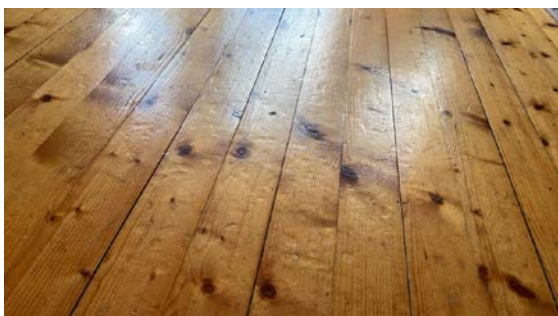
Merker og slitasje på gulvoverflate
