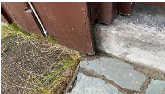
Vedlikeholdsbehov med bobler på maling
