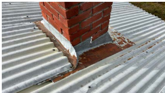
Rust/slitasje på fotbeslag og må påregnes nytt fotbeslag og etableres heldekkende pipebeslag for å unngå innvendig fuktpåkjenning
