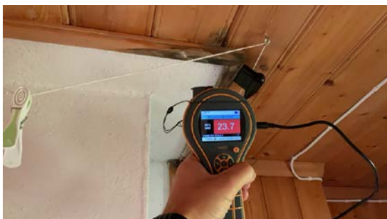
Fuktskjolder med muggsopp ved pipestamme fra vaskerom, ved fuktmåletaking var det fuktutslag der tiltak av årsak og skadeomfang må foretas
