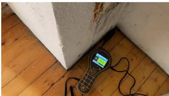
Ved fuktmåletaking av gulv og ved fuktmåletaking av gulv var det fuktutslag
