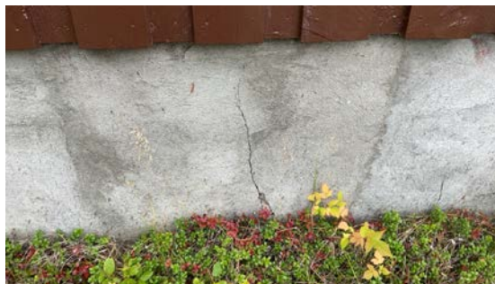
Sprekk i mur
