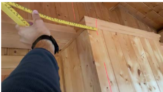
Ved stipprøvetking er det på vegg målt skjevhet på oppmot 60 mm på 2 m høyde
