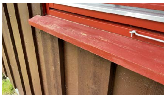
Vedlikeholdsbehov på vannbrett
