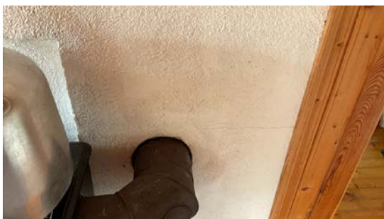
Riss/sprekke dannelse ved røykinnføring
