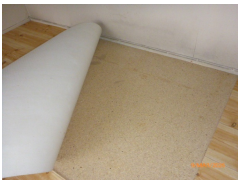
Gulv med løst belegg mot øst.
