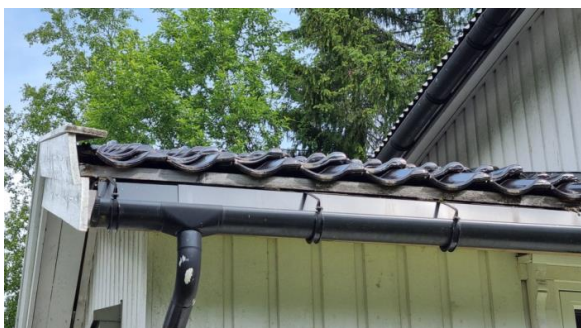
Det er ufagmessig utførelse av taktekke (glipper mellom takpanner og ujevnt lagt).
