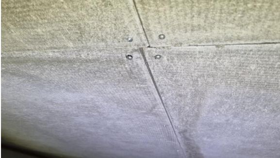
Plater inneholder asbest.
