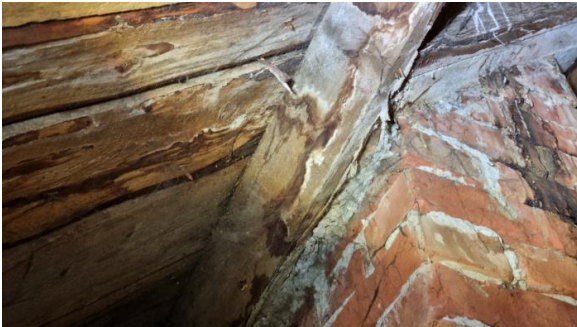
Fuktmerker ved pipen.
