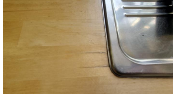
Fuktskade i benkeplate ved vask.
