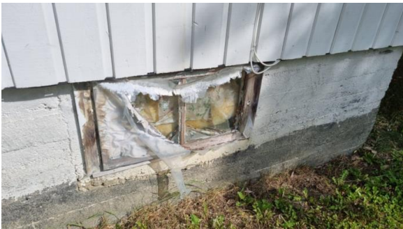
Glass er skadet.
