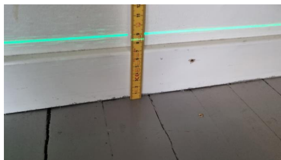
Kontroll av planavvik.
