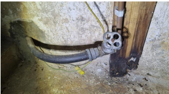
Hovedstoppekran av eldre dato uten kuleventil.
