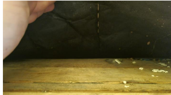
Det ble ikke registrert dampsperre.
