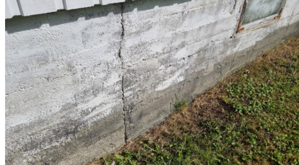
Sprekk i grunnmur.
