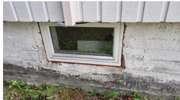
Det er ikke tilfredsstillende tettet rundt vindu.
