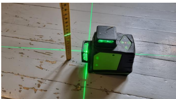
Kontroll av planavvik.
