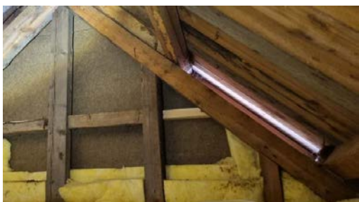
Luftespalte i gavlvegg.
