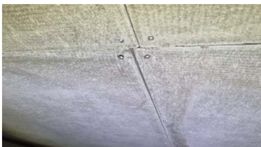
Plater inneholder asbest.
