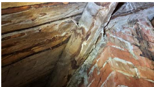
Fuktmerker ved pipen.
