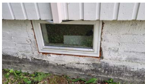
Det er ikke tilfredsstillende tettet rundt vindu.
