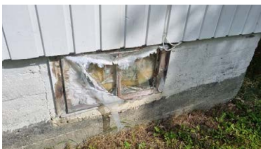
Glass er skadet.
