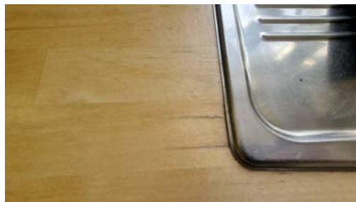
Fuktskade i benkeplate ved vask.
