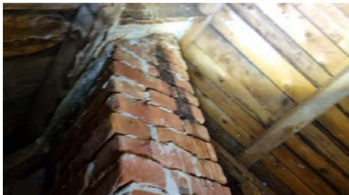
Pipa har rennemerker etter sotvann.
