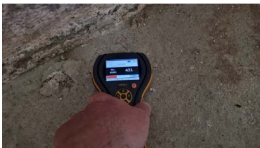
Det ble registrert forhøyde fuktverdier.
