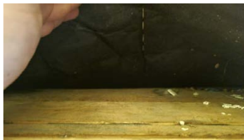
Det ble ikke registrert dampsperre.
