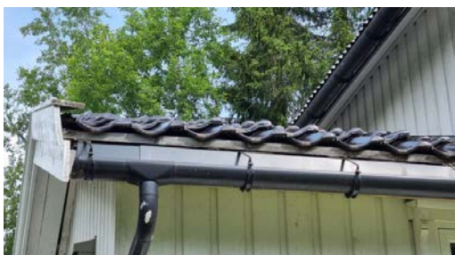
Det er ufagmessig utførelse av taktekke (glipper mellom takpanner og ujevnt lagt).
