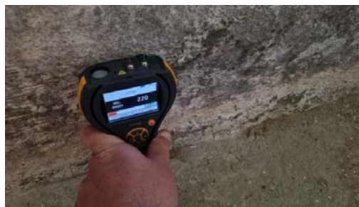
Det ble registrert forhøyde fuktverdier.
