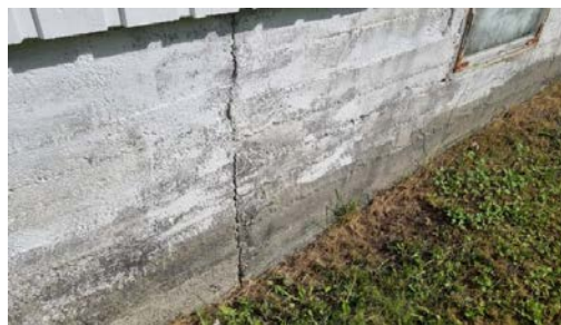
Sprekk i grunnmur.
