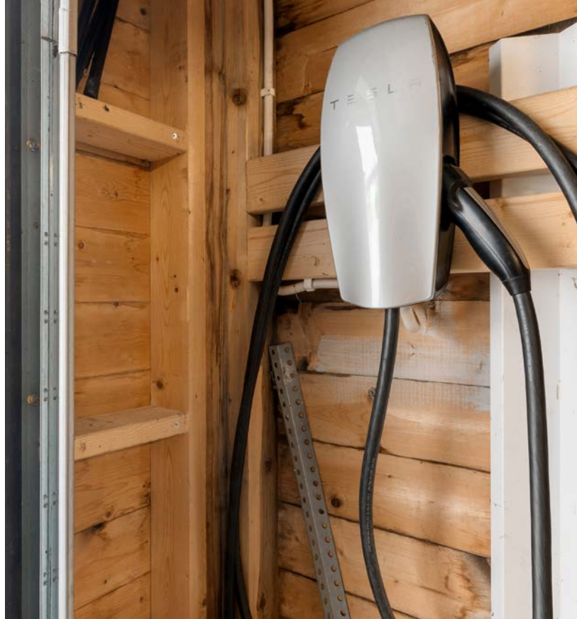
I garasjen er det montert Tesla el-bil lader.
