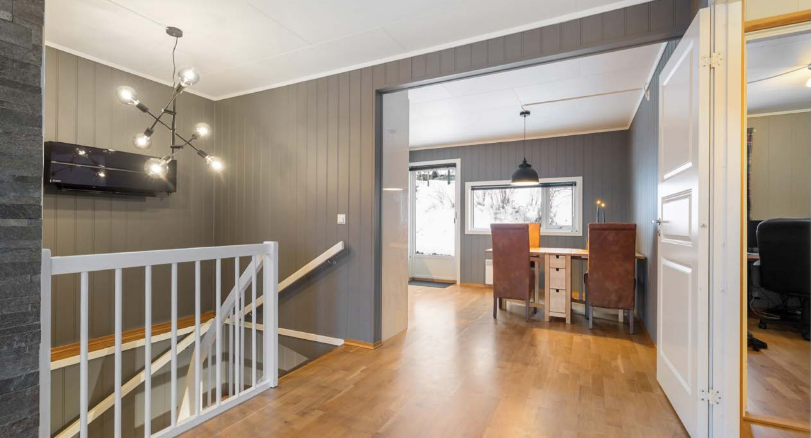
Det er montert luft til luft varmepumpe på veggen ved trappen.
