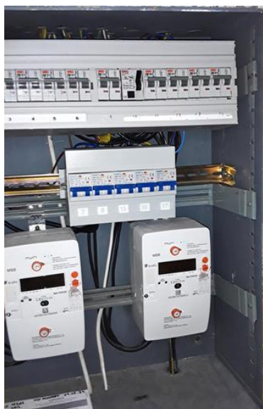
Elektrisk anlegg - [Sikringsskap]
