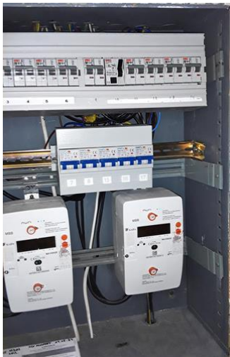
Elektrisk anlegg - [Sikringsskap]
