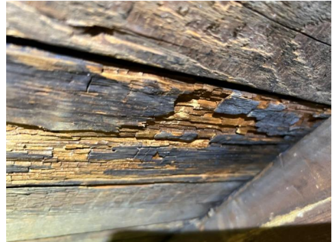
Råte i undertak
