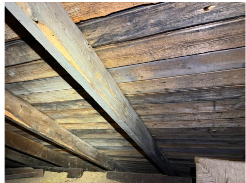
Svertesopp på undertak
