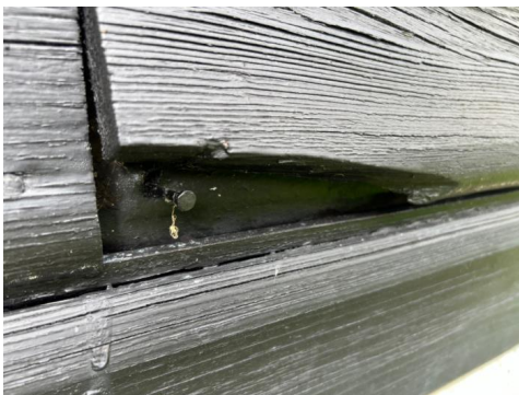
Bemerket skade på enkelte bord
