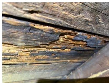
Råte i undertak
