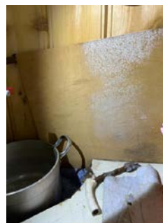
Muggdannelse på plate i kjøkkenskap
