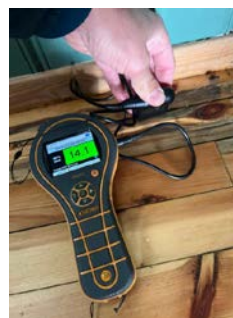
Fuktpreget gulv på kjøkken, ved fuktmåletaking var det fuktinnhold noe over normalt fuktinnhold
