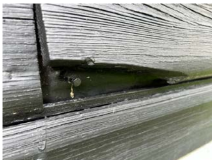
Bemerket skade på enkelte bord
