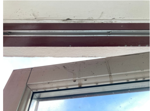
Merker etter tidl fukt i overkant vindu
