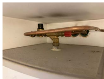
Merker etter varme i takplater
