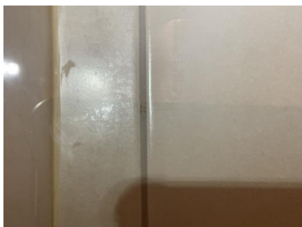
Sprekk i fuge i dusjsone.
