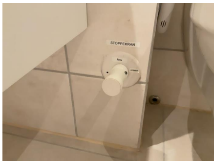
Vrider til stoppekran plassert på bad.
