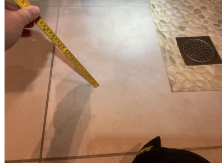
Bom/hullyd registrert på flere fliser.
