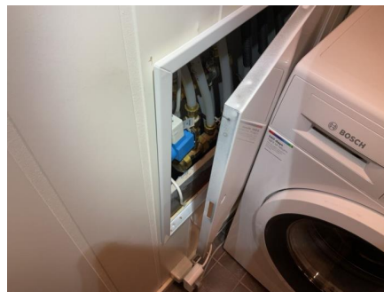
Fordelerskap for vann plassert på rom med opplegg til vaskemaskin.
