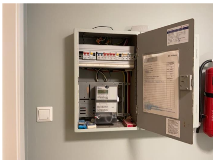
Sikringsskap plassert i felles oppgang.
