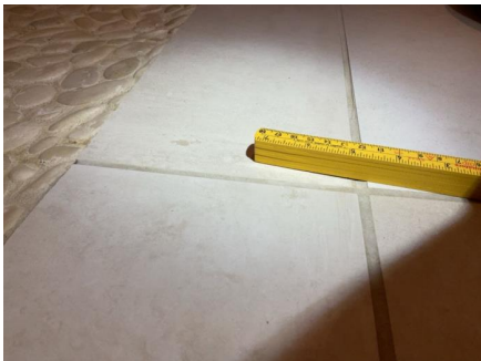
Noe ujevne overflater enkelte steder.
