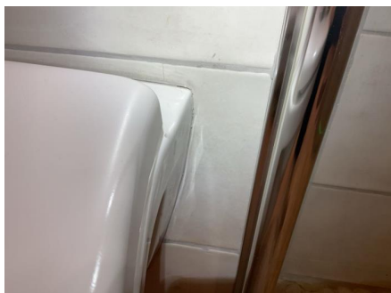
Sprekker i flis rundt vegghengt toalett.
