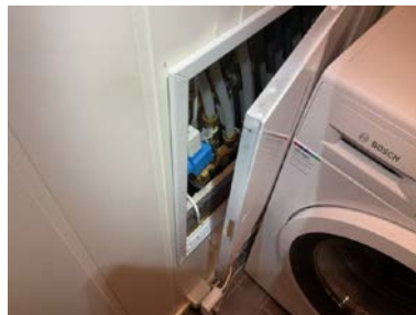
Fordelerskap for vann plassert på rom med opplegg til vaskemaskin.
