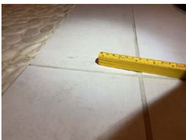
Noe ujevne overflater enkelte steder.
