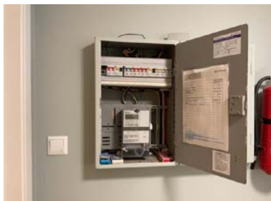
Sikringskap plassert i felles oppgang.
