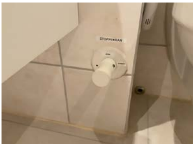
Vrider til stoppekran plassert på bad.
