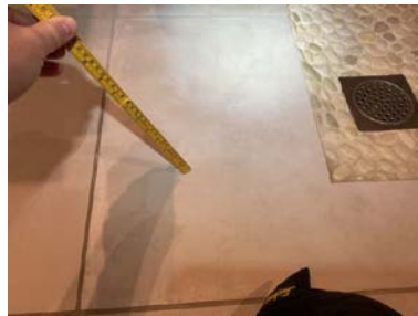
Bom/hullyd registrert på flere fliser.
