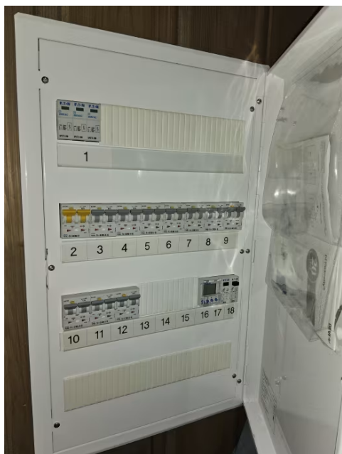
Bilde viser sikringsskap.
