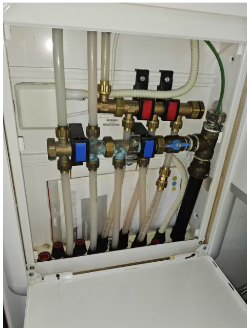
Bilde viser fordelerskap for rør i rørsystem.
