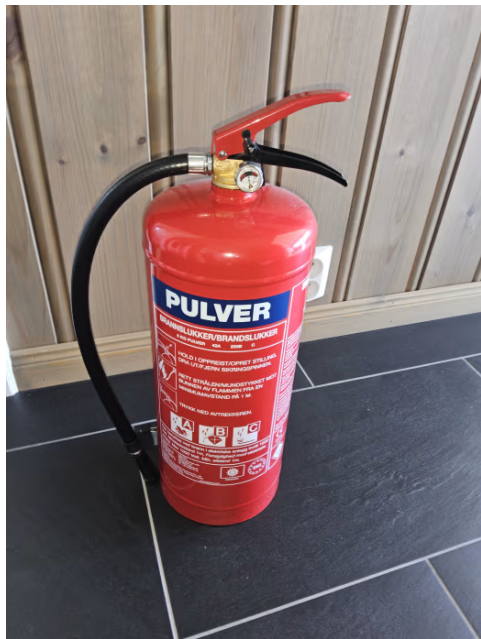
Bilde viser brannslukningsapparat.
