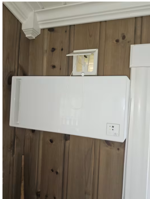
Bilde viser klaffventil og ventilasjonsaggregat.
