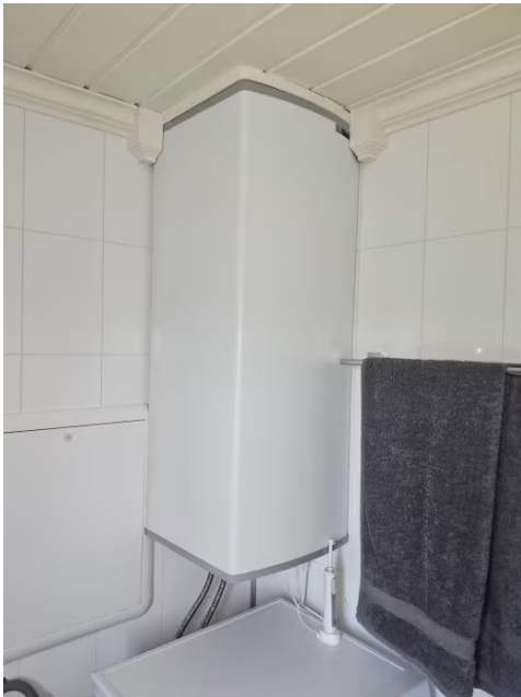
Bilde viser varmtvannsbereder.
