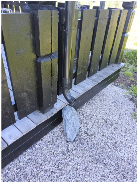
Bilde viser taknedløp avsluttet over bakken.
