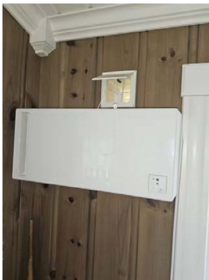
Bilde viser klaffventil og ventilasjonsaggregat.
