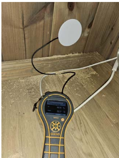
Bilde viser fuktmåling.
