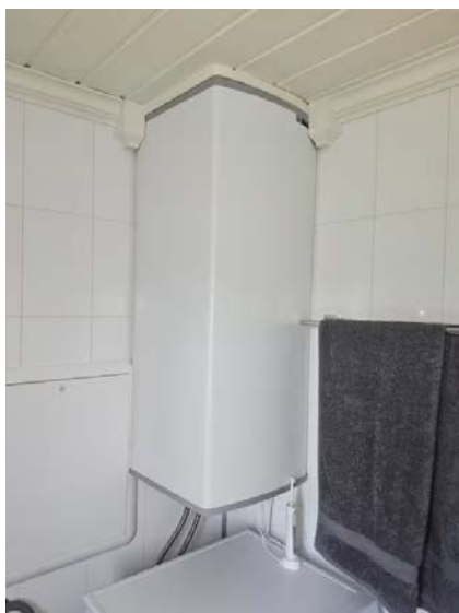
Bilde viser varmtvannsbereder.
