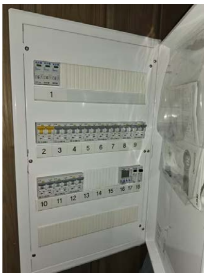
Bilde viser sikringsskap.
