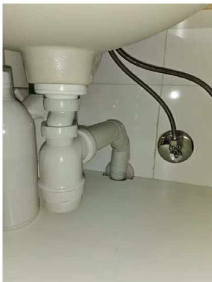
Bilde viser avløpsrør på bad.
