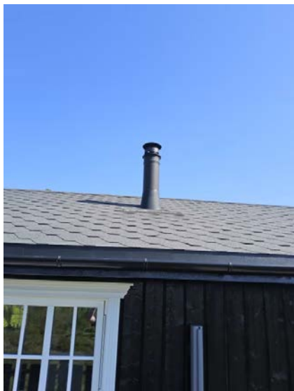
Bilde viser manglende takstige.
