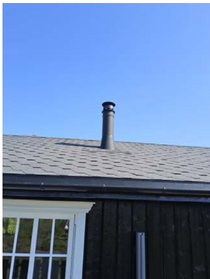
Bilde viser manglende takstige.
