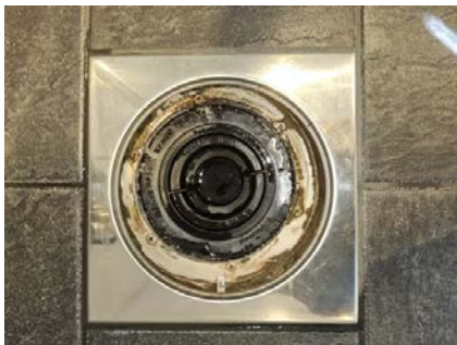
Bilde viser sluk.
