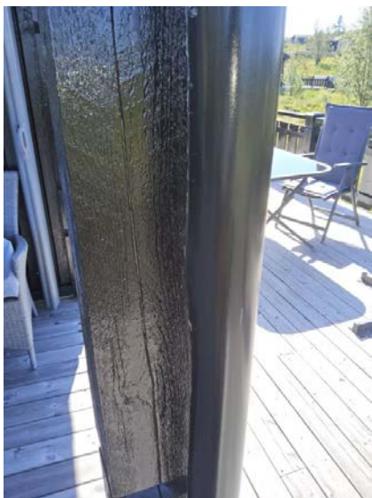
Bilde viser buling i taknedløp.
