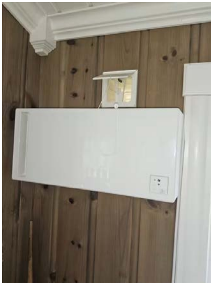
Bilde viser klaffventil og ventilasjonsaggregat.
