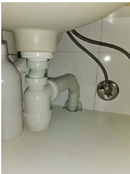
Bilde viser avløpsrør på bad.
