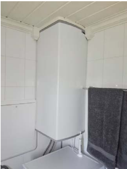
Bilde viser varmtvannsbereder.
