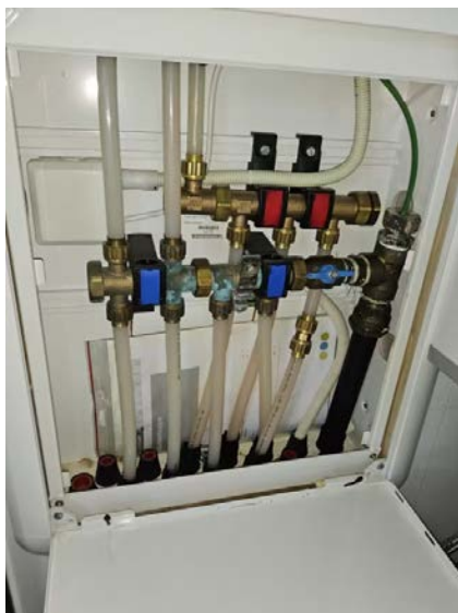
Bilde viser fordelserskap for rør i rørsystem.
