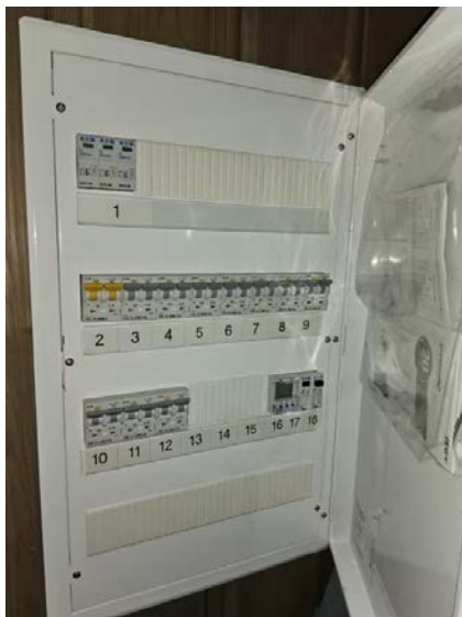
Bilde viser sikringsskap.
