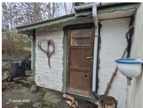
Slitt dør og slitte fasader.
