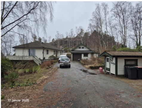
Oversiktsbilde som også viser de forskjellige takflatene. Vedlikehold og utskiftninger trengs.
