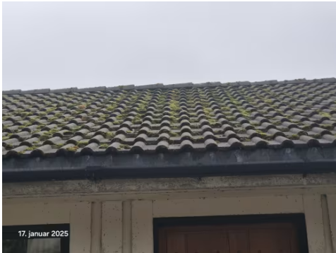
Mosegroing på tak.
