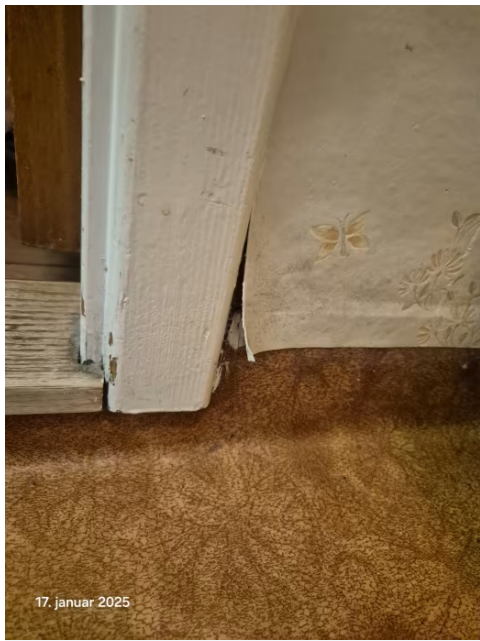
Bad 1.etg. Utette overflater.
