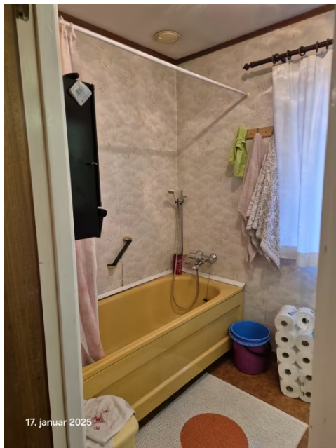
Bad i 1.etg. Generelt slitt.
