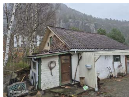
Generelt slitte fasader på garasje.
