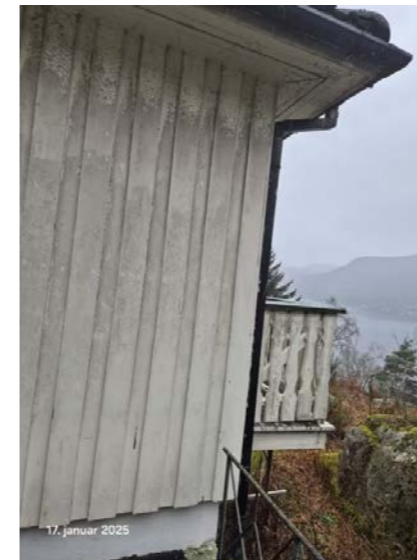
Svertesopp/avskallinger jevnt over.
