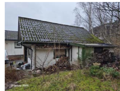
Mosegroing på tak, bærer preg av lite vedlikehold. Dette svekker levetiden.
