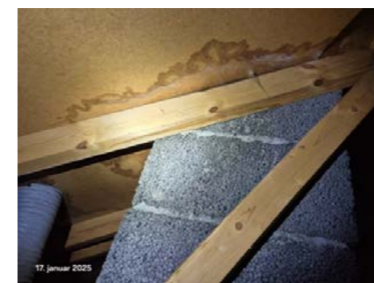
Fuktskjolder i undertak.
