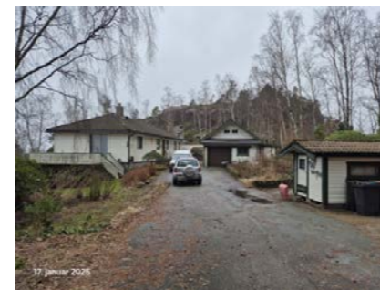
Oversiktsbilde som også viser de forskjellige takflatene. Vedlikehold og utskiftninger trengs.
