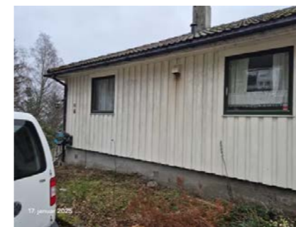
Generelt slitte fasader på bolig.
