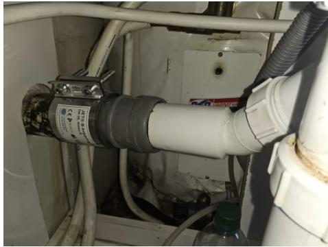
Varmtvannsbereder er plassert i kjøkkeninnredning.
