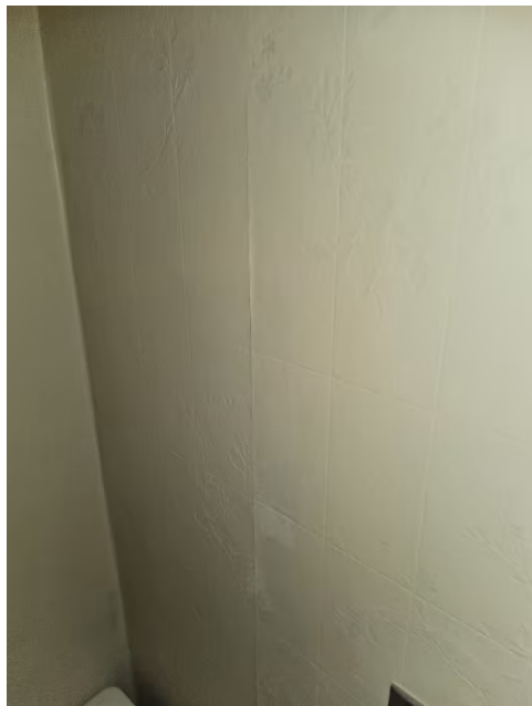
Løse skjøter på våtromstapet i dusjsone.
