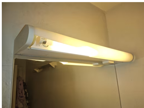
Ødelagt deksel på lysarmatur over servant.
