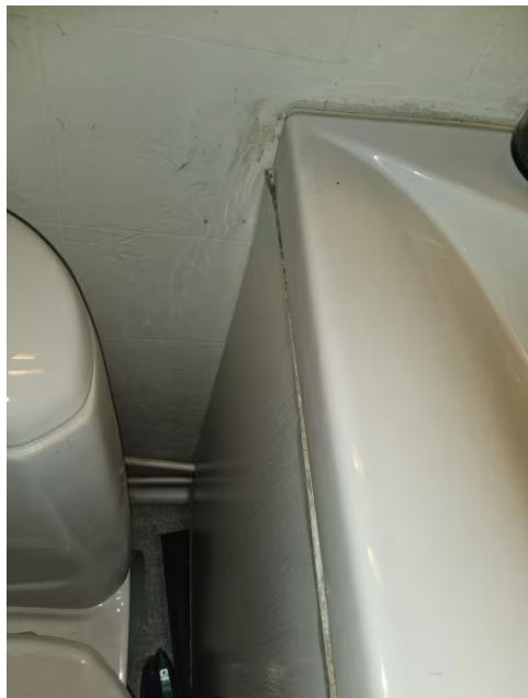
Svelleskader på baderomsinnredning.
