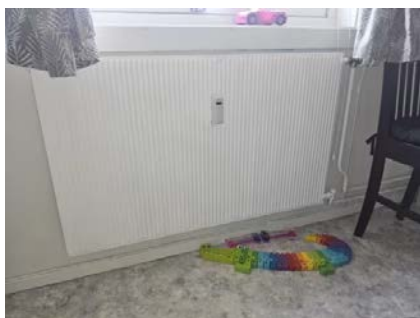
Leiligheten er oppvarmet med radiatorer.
