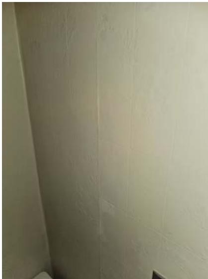
Løse skjøter på våtromstapet i dusjsone.
