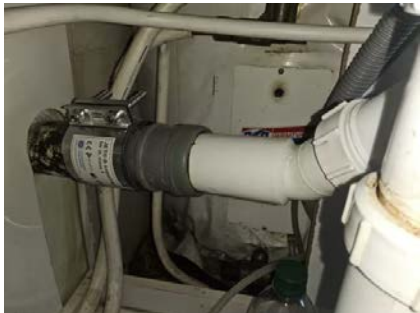
Varmtvannsbereder er plassert i kjøkkeninnredning.
