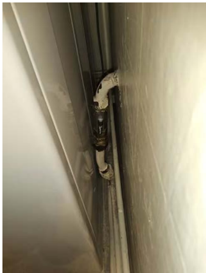
Hovedstoppekran er plassert på bad.
