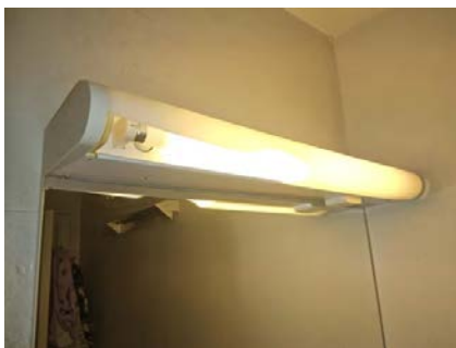
Ødelagt deksel på lysarmatur over servant.
