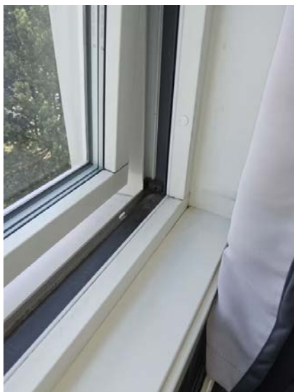
Tegn til fuktpåvirkning etter kondens registreres i enkelte vinduskarmer.
