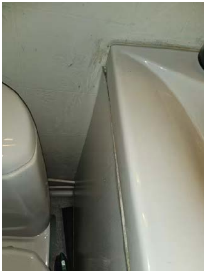
Svelleskader på baderomsinnredning.
