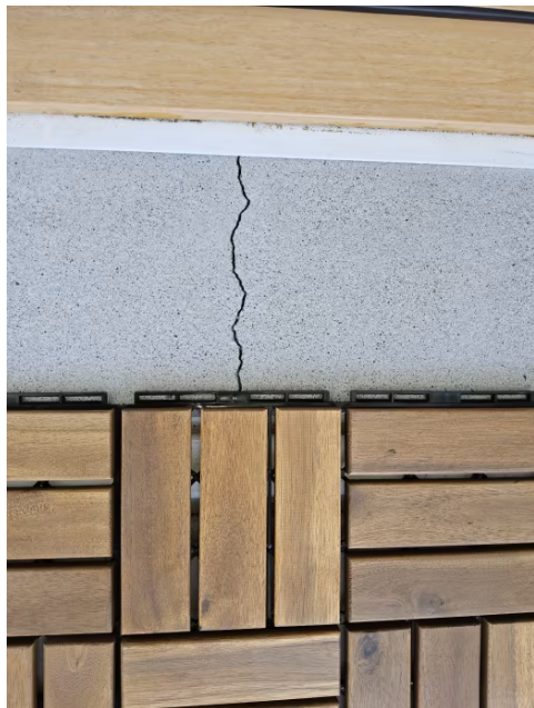
Bilde viser sprekk i betongdekke.
