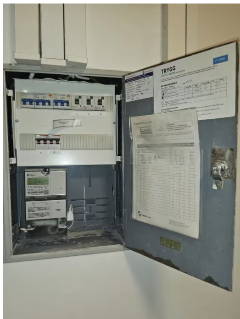
Bilde viser sikringsskap.
