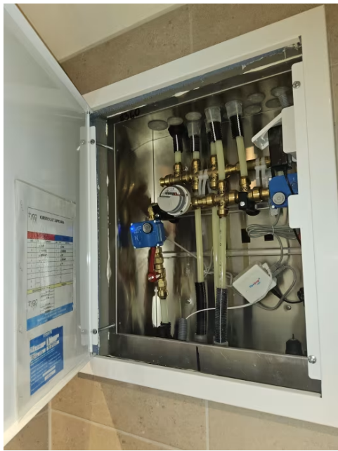
Bilde viser fordelerskap for rør i rørsystem.
