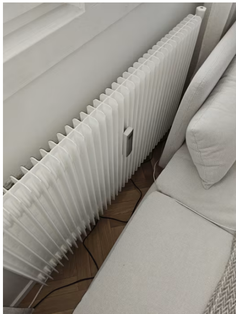
Bilde viser radiator.
