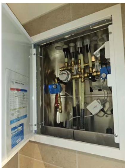
Bilde viser fordelerskap for rør i rørsystem.
