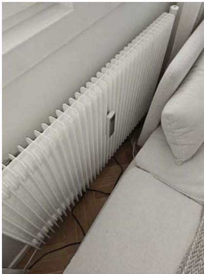
Bilde viser radiator.
