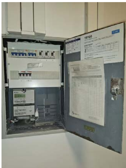
Bilde viser sikringsskap.
