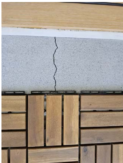
Bilde viser sprekk i betongdekke.
