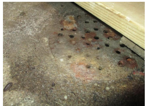
Eldre opprinnelig sluk.
