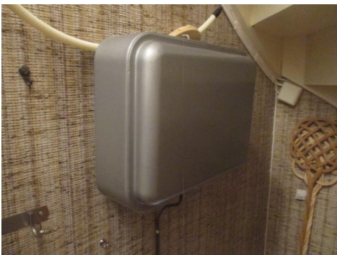
Dagtank i trappegangen.
