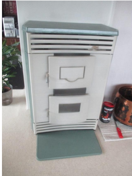
Oljebrenner har ikke vært i bruk på lang tid i følge eier.
