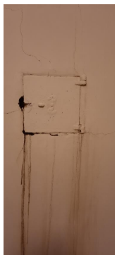
Eldre feierluke på loftet med noe sotrenning
