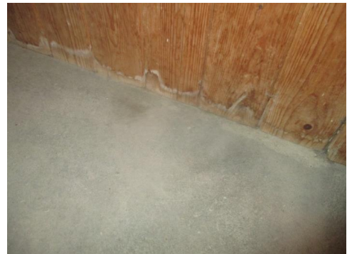
Ingen fuktsikring i overgang gulv og skillevegger.
