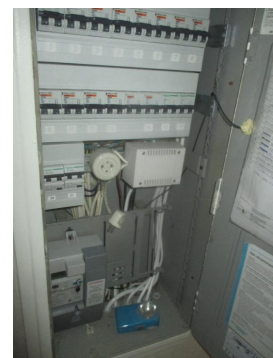
Blitt oppgradert med automatsikringer.
