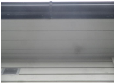
Ingen luftespalter i gesimser for tilgang på luft til lukket konstruksjon.
