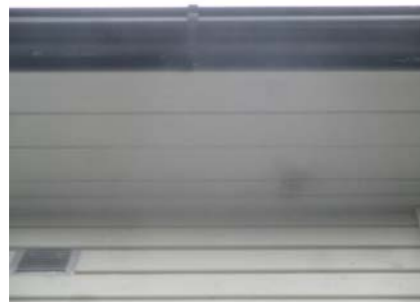
Ingen luftespalter i gesimser for tilgang på luft til lukket konstruksjon.
