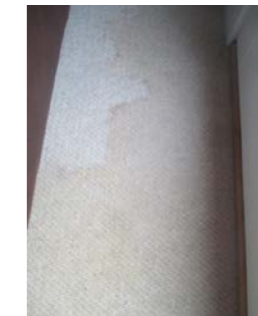
Fuktmerker på teppe ved nyere skyvedør.
