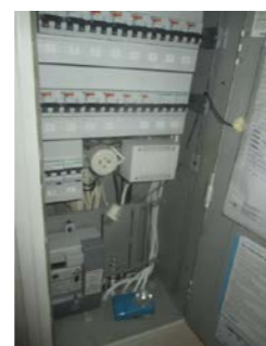
Blitt oppgradert med automatsikringer.
