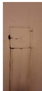
Eldre feierluke på loftet med noe sotrenning
