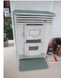
Oljebrenner har ikke vært i bruk på lang tid i følge eier.
