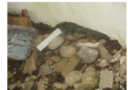
Eldre opprinnelig fuksikring.
