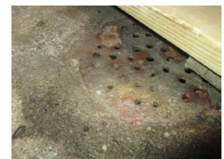
Eldre opprinnelig sluk.
