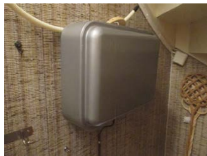
Dagtank i trappegangen.
