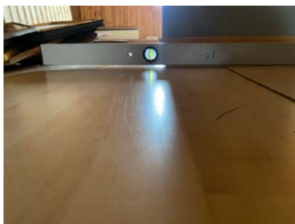
Laminat i loftsetasje er gått fra hverandre i skjøte.
