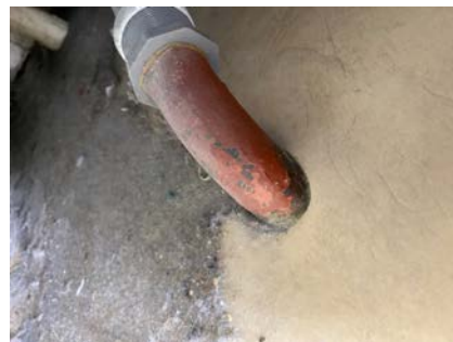
Rørgjennomføring fra dusjkabinett i gulvet
