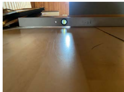
Synlige skjevheter i gulv.
