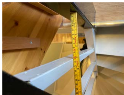
Åpninger i rekkverk
