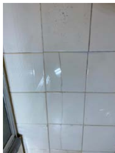
Sprukket/løse fliser. Svartesopp.
