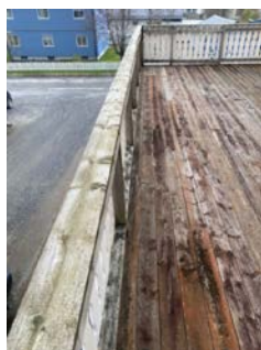
Skjevheter i rekkverk, delvis råteskader i rekkverk.
