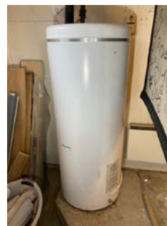
Varmtvannstank er plassert på boden i kjeller.
