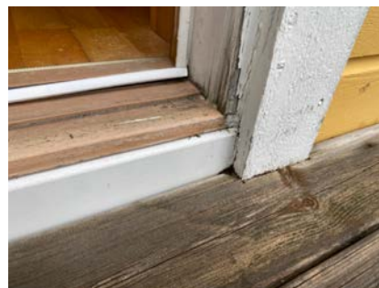
Råteskade i nedkant karm.
