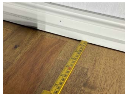
Glippe mellom list og gulv.
