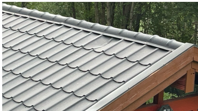
Bilde tatt fra skråning (bulk i takplate)
