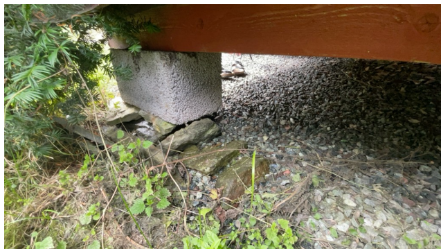
Noe skjevhet/synk i fundament
