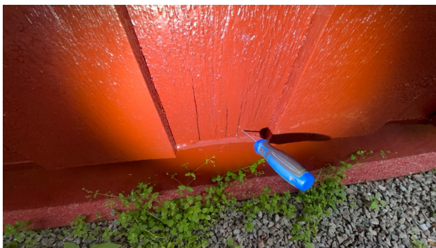
Sprekker og partiell råte i endevend
