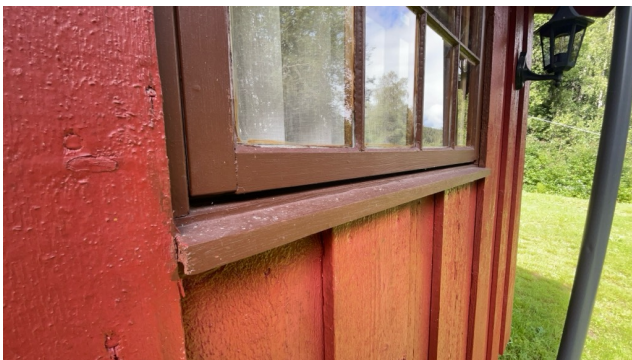
Ikke beslag på vannbrett
