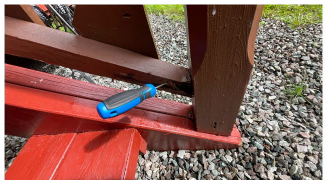
Råte losholt for rekkverksbord i trapp
