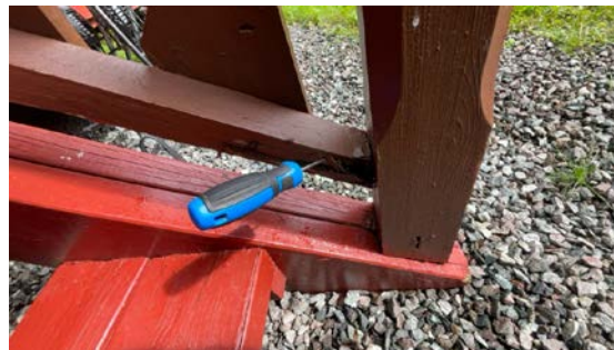
Råte losholt for rekkverksbord i trapp
