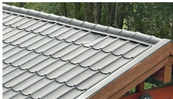
Bilde tatt fra skråning (bulk i takplate)
