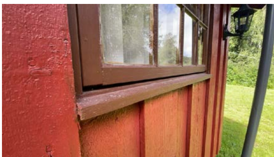
Ikke beslag på vannbrett
