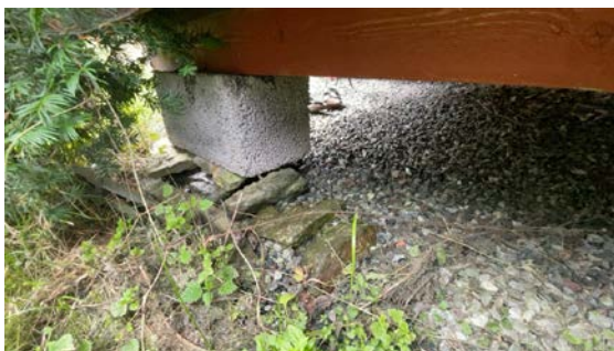
Noe skjevhet/synk i fundament
