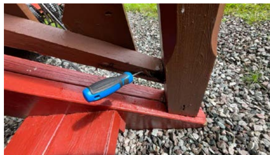
Råte losholt for rekkverksbord i trapp
