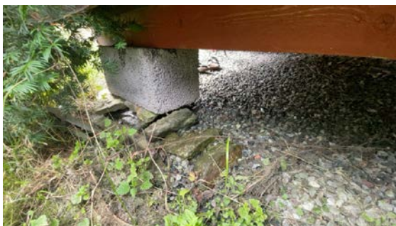
Noe skjevhet/synk i fundament
