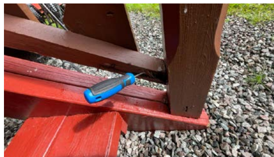
Råte losholt for rekkverksbord i trapp
