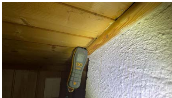
Fuktig treverk i skjolde på pipeside mot vedovn
