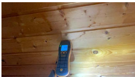
Liten skjolde over kjøkkenkum- ikke unormal fukt ved måling.
