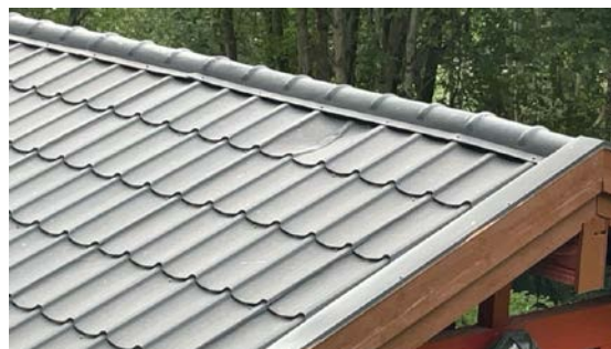
Bilde tatt fra skråning (bulk i takplate)
