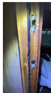
Bulkete beslag, sprekk i karm og ufagmessige tettelister.
