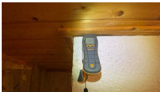
Skjolde/sverte overside pipe- ikke unormal fukt ved måling.
