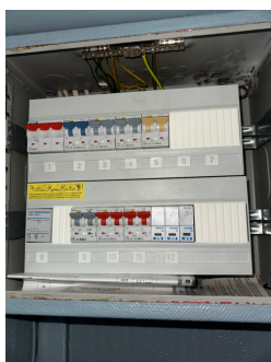
Sikringsskap med automatsikringer.
