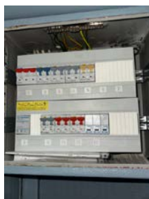
Sikringsskap med automatsikringer.
