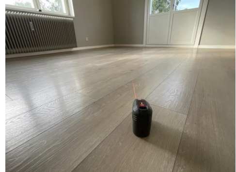
Nivellering stue/kjøkken, avvik ca. 10-20 mm
