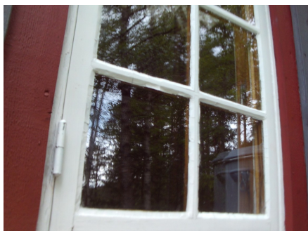
En del vedlikehold må beregnes på denne type vinduer.
