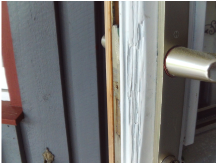
Skade på selve rammen ved låsekasse.
