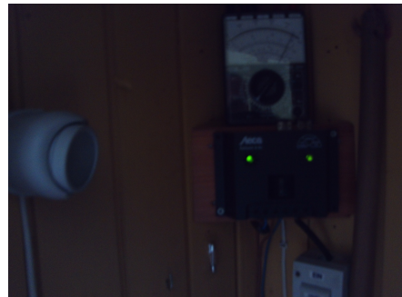
Regulator er plassert i et skap på hygnerom.
