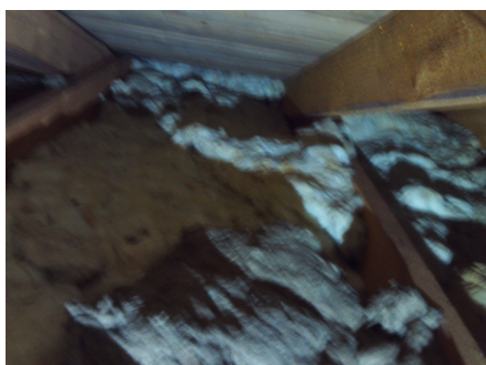
Ingen/lite tilgang på luft ved takutstikk
