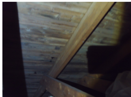
Noe misfarging på undertaket
