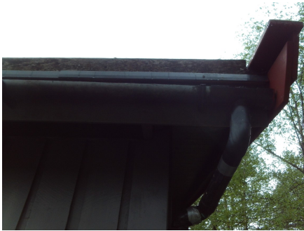
Deler av eldre slitte takrenner og nedløp.
